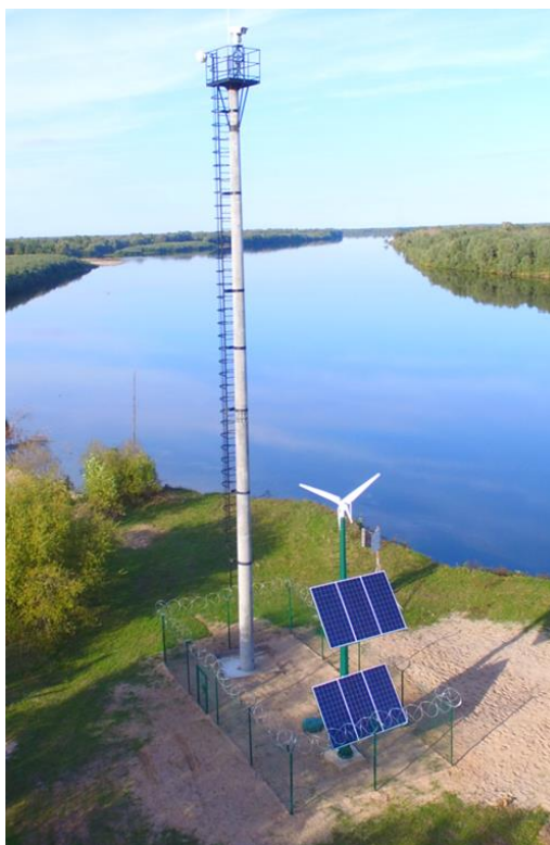
Рисунок 1. – Электроснабжение АПТН от солнечных фотопанелей и ветряка
